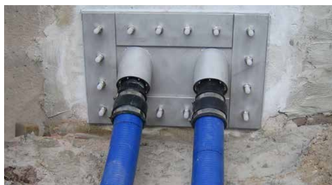
zastosowano flansze stalową z ukośnym podejściem i gumowymi wkładami uszczelniającymi
