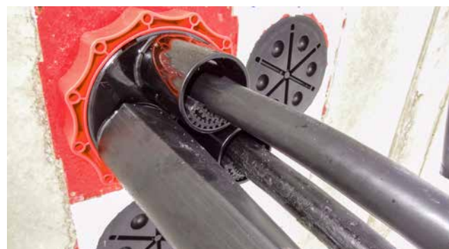
taśmy centrujące zamontowane wewnątrz króćców pokrywy HSI150 D3x58 WS
